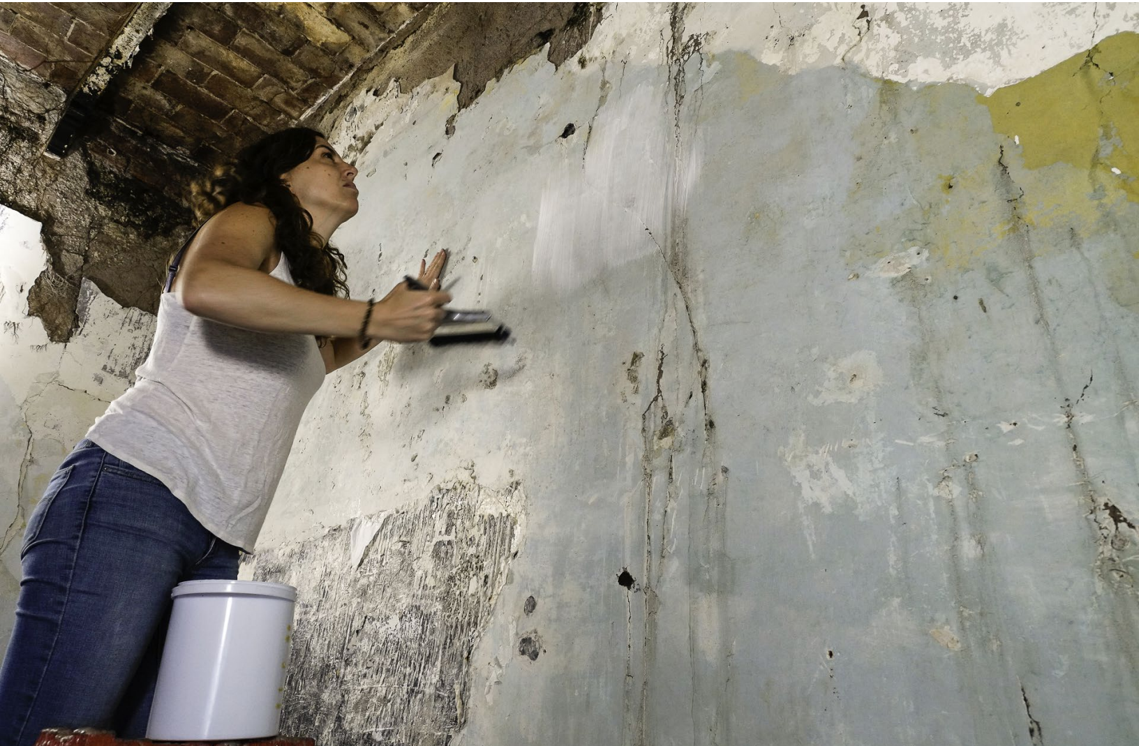
Desprendimiento del recubrimiento del muro, 2019.
