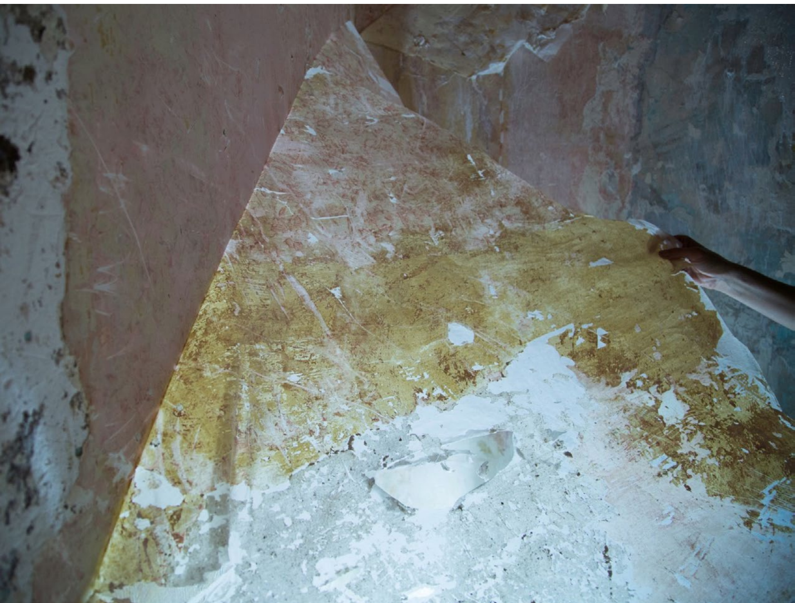
Desprendimiento del recubrimiento del muro de una habitación, 2019.
